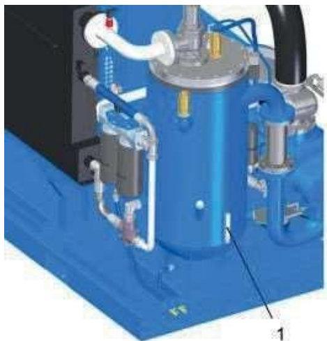
Рис. 36: Проверка уровня компрессорного масла через смотровое стекло
